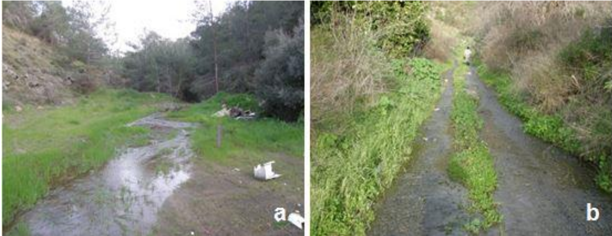
Σχήμα 32: (a) Έξοδος του ποταμού από το δασικό τμήμα κατόπιν του Φράγματος της Αγίας Μαρίας (b) Μετατροπή της κοίτης σε γεωργικό δρόμο. Προφανώς αυτό το τμήμα ποταμού είναι τεχνητώς εφήμερης ροής. (Φώτο: Ι. Τζιωρτζιής, Φεβρουάριος 2013).
